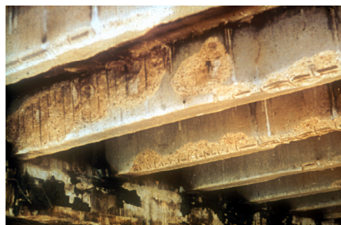
Obrázok CS1.2: Príklad betónových prvkov po požiaru znázorňujúci odlupovanie (odpraskávanie) betónu (so zvolením DBV, Nemecko)
