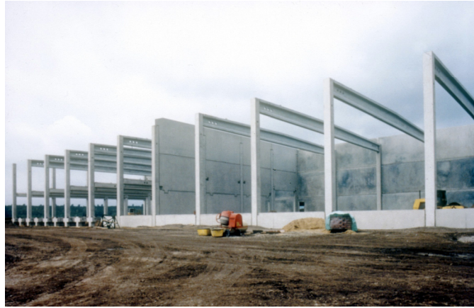
Obrázok 2.3: Prefabrikované steny vytvárajú požiarne úseky tohto skladovacieho zariadenia. (so zvolením BDB, Nemecko)
